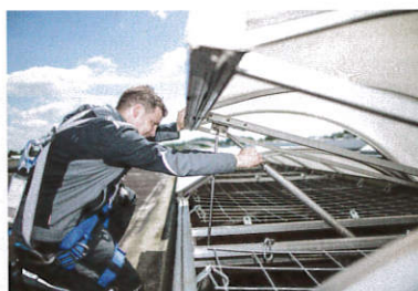
BRANDSCHUTZ Wartung ist wichtig
