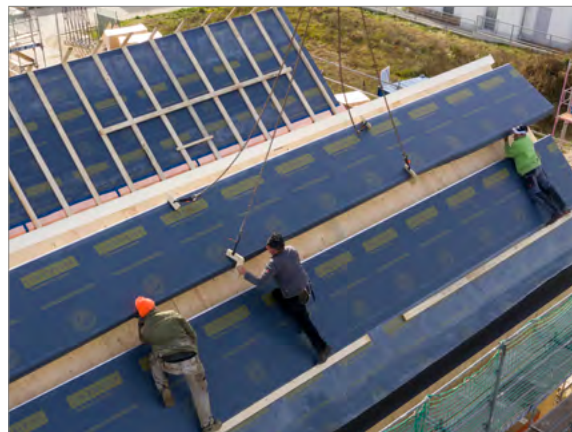
4. Elemente auf dem Dach ablassen. Die Plattenunterkanten von Hand anheben, sodass die Luftdichtheitsbahn nicht beschädigt wird und die Hebehilfen entfernt werden können. Die Dämmplatten auf dem Sparren ablegen und in die Kantenverbindung einschieben.
